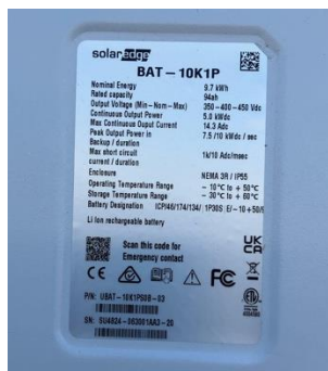
Solar Edge Battery Placard
